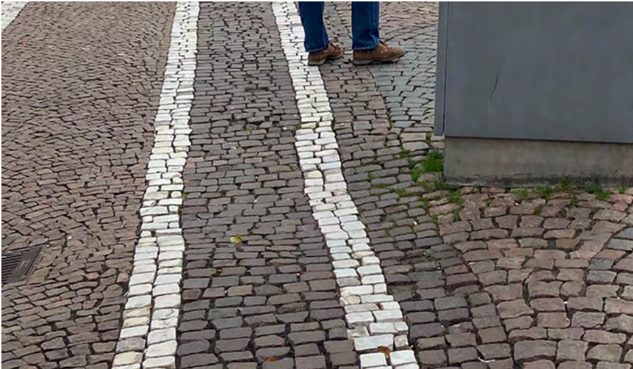
Pflasterung kaputt, uneben, Fugen zu groß, für Mobilitätseingeschränkte ungeeignet
